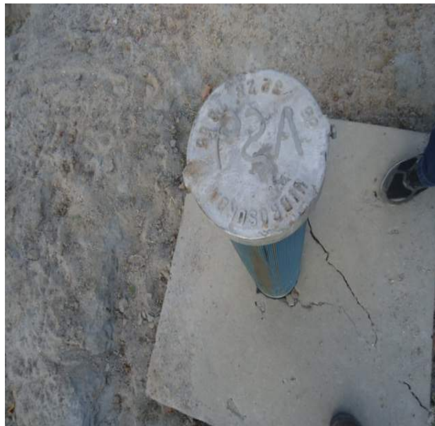
Figura 10 – Detalhe da nomenclatura do poço e da rachadura presente na laje
